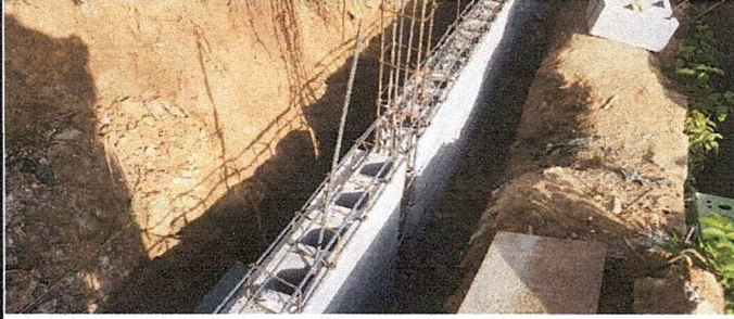
Foto 1: Inicio del mejoramiento del muro perimetral, colocación de block y armadura de hierro.
